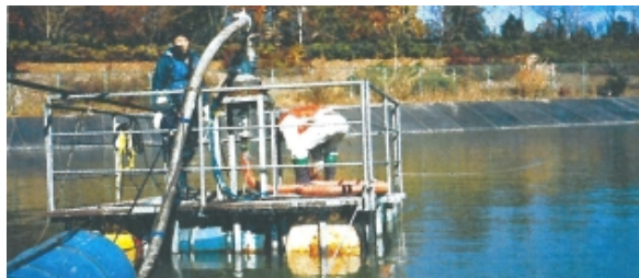
①濁水を水中ポンプにて吸上げ、乱流発生装置に送る。
